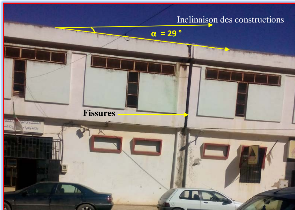
Photo.VI.3 : Désordres sur les constructions
