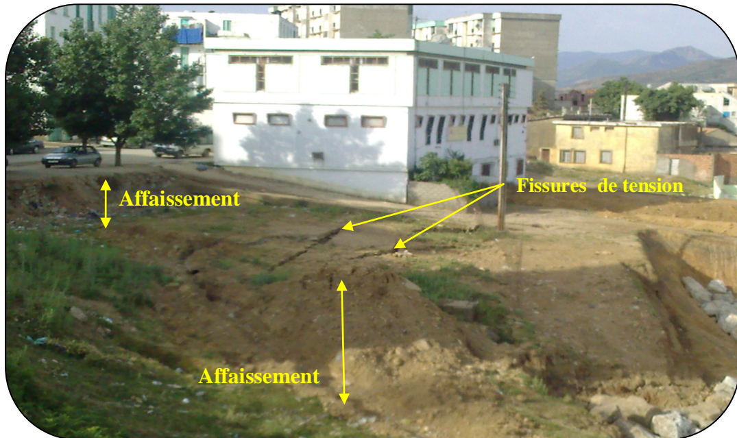
Photo.VI.2 : Crevasse et fissure parallèles au front de taille.
