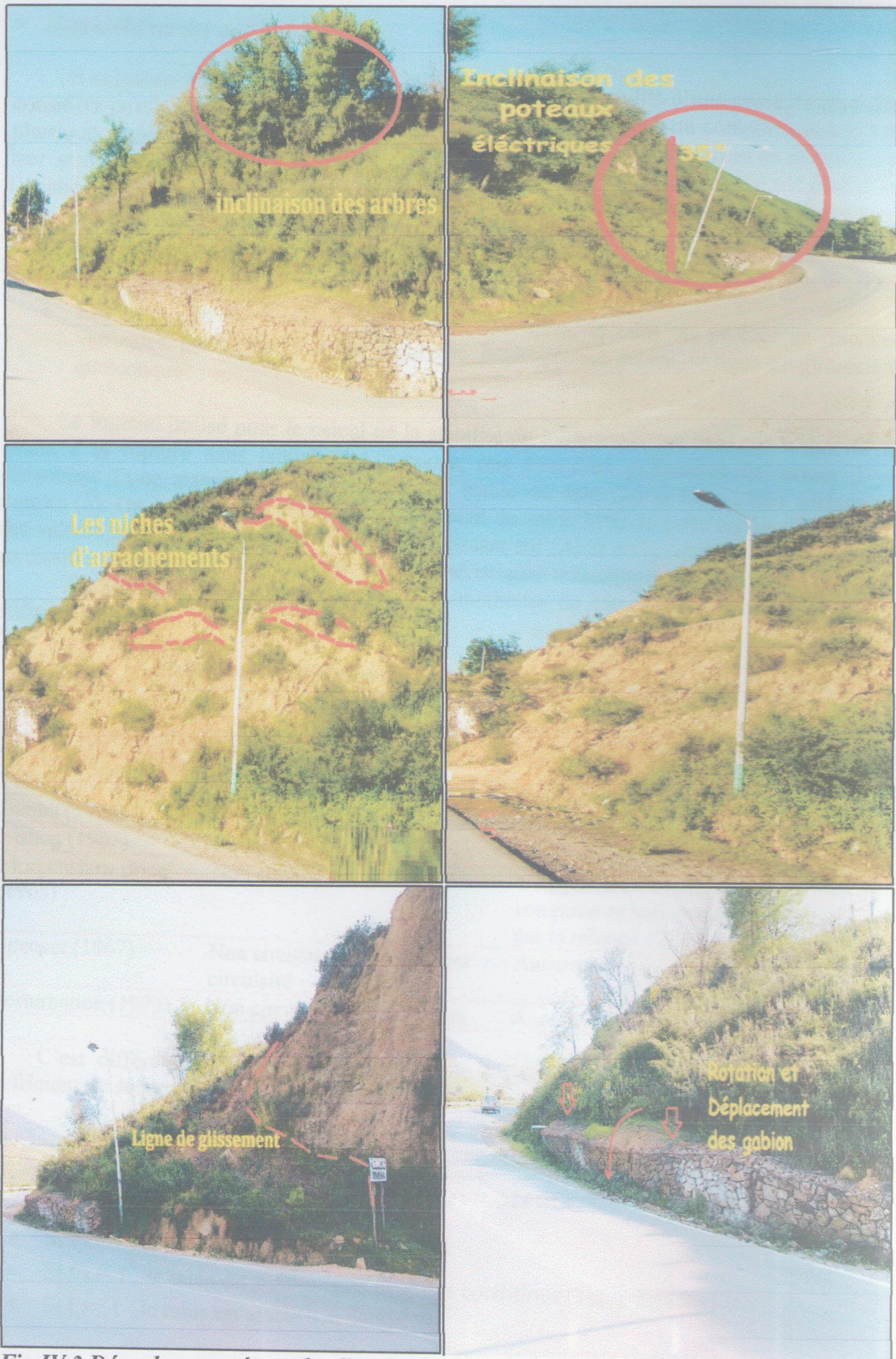
Fig.IV.3 Désordres causés par le glissement
