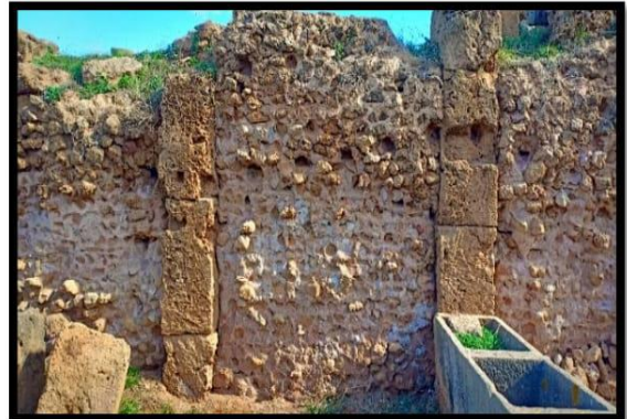
Figure 56: Dégradation au niveau de liant des pierres à cause de l'humidité
