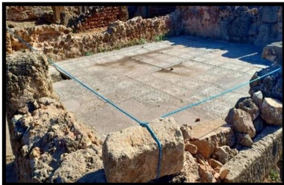
Figure 60: Un état très dégradé au niveau des mosaïques utilisé sur sol.
