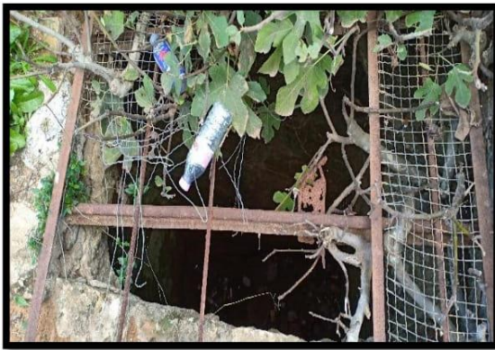
Figure 50: L'absence de maintenance
