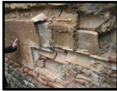
Figure n° III .19 : Dégradation de la voûte des thermes du Baptistère de Djemila
