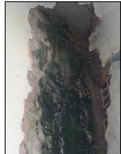
Photo5-1: Effet des ponts thermiques sur l'atelier 28 Source : Auteur
