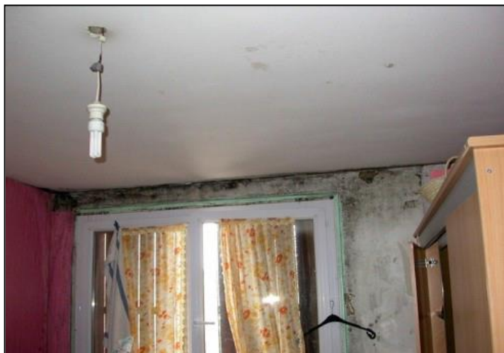
Figure 16: Moisissure sur la surface de matériaux. Source : http://www.developpement-durable.gouv.fr
