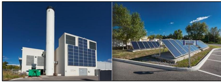
Figure 46: La chaufferie bois de CHA Cévennes et les panneaux solaires thermique. Source : (contrôleur général des lieux de privation de liberté, 2015).
