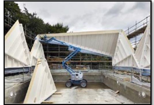
Photo N°31 : Montage des panneaux à ossature formant la coque plissée qui recouvre la piscine d'après (hobhouse,2015)
