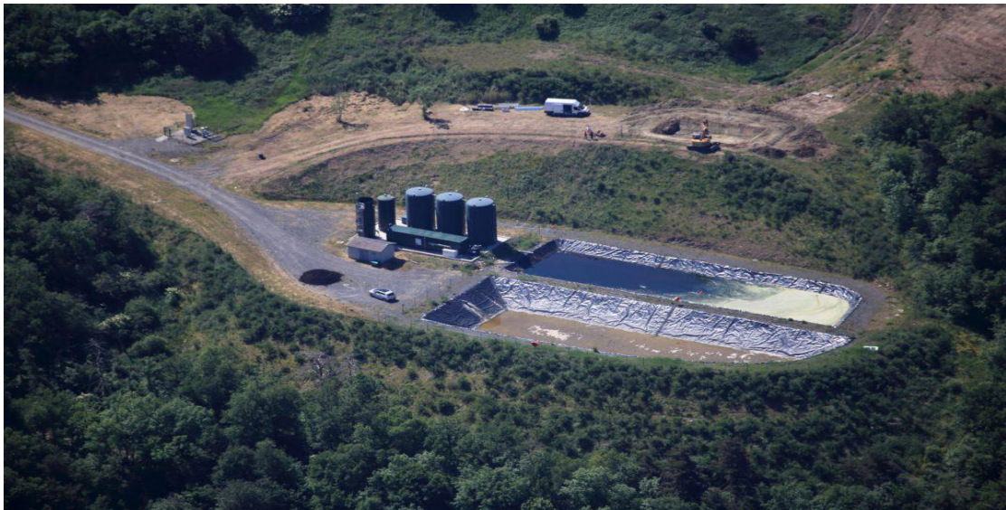
Fig.3.3: Station de traitement des lixiviats
