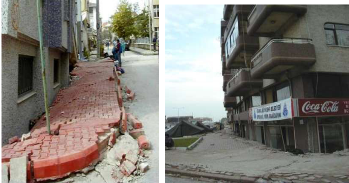
Figure I-19 Poinçonnement de la fondation sous la liquéfaction séisme Turquie 1999
