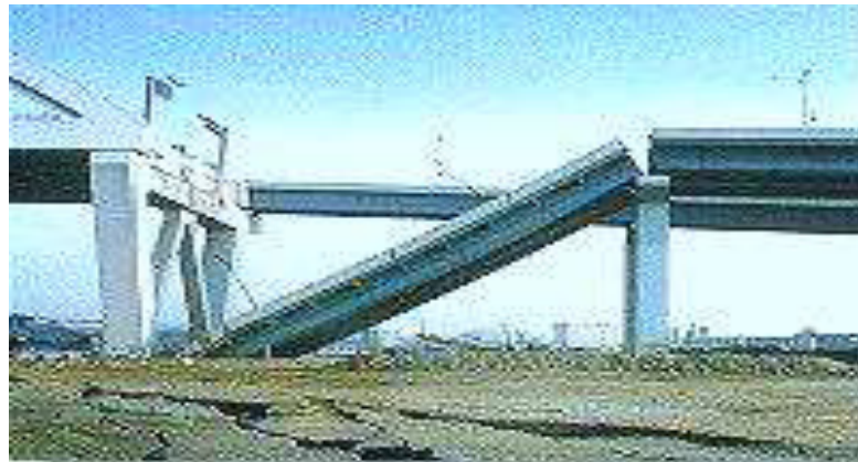
Figure I-13 Endommagement des ponts : Un tel dommage peut avoir des conséquences désastreuses, empêchant même les opérations de sauvetage. Les mouvements induits par la liquéfaction peuvent pousser les bases hors du point où le pont enjambe l'appui, dans ce cas le pont lâche
