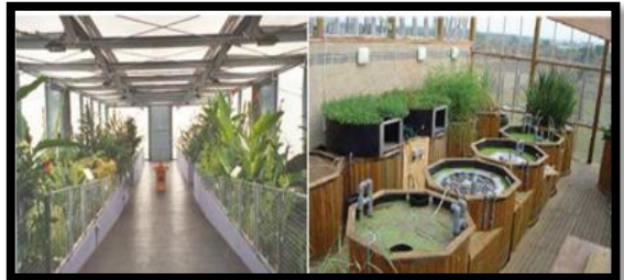
Photo 6: Le système de traitement biologique des eaux usées. Source: http://www.ecosources.info .
