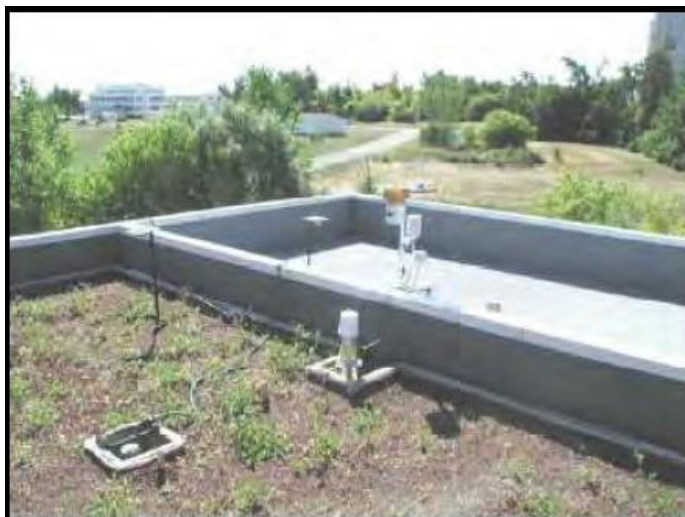
Figure 2.6 : Séparation des deux toits : le toit vert (à gauche) et le toit de référence (à droite)
