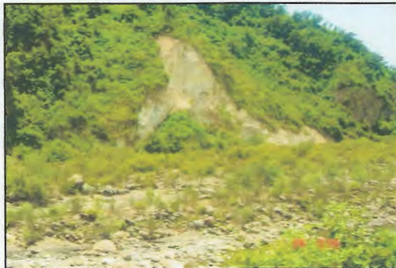
Photo. II.2: Photo illustrant un effondrement du Trias des environs immédiats de l'implantation de la deuxième culée du viaduc (Kherrouba.H)
