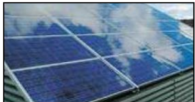
Figure 10 : Photos des panneaux solaires installés sur le toit du centre de Glashustt de Hammarby.
