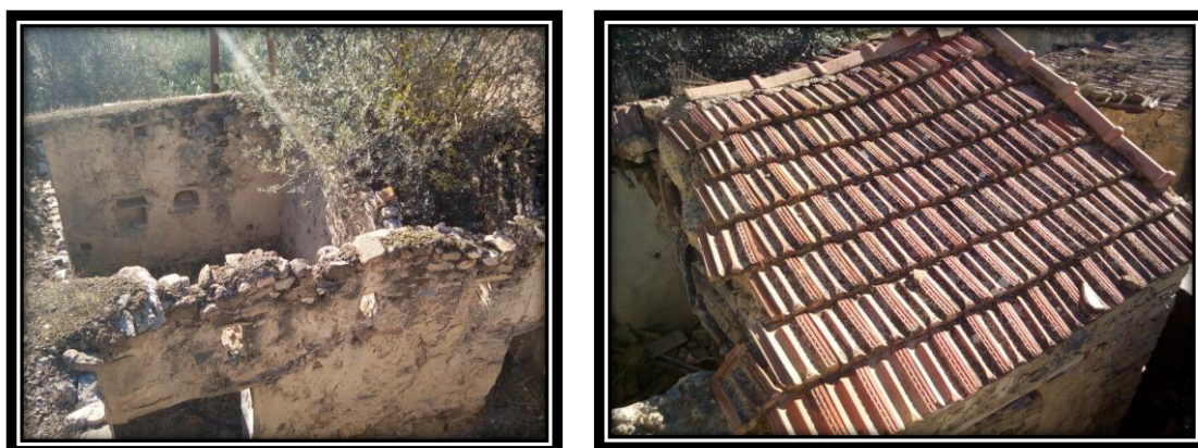
Photos n°12 : Maisons rurales traditionnelles kabyle en état de dégradation avancée.
