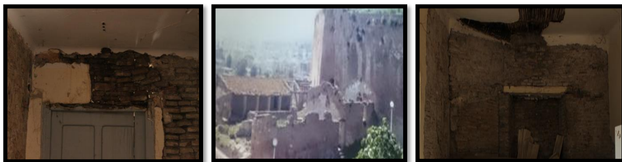
Figure 55 : les différents pathologies sur la maçonnerie des composantes de la casbah
