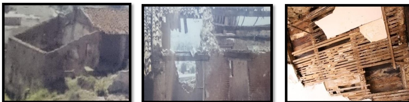
Figure 54 : les différents pathologies sur les planchers et les couvertures
