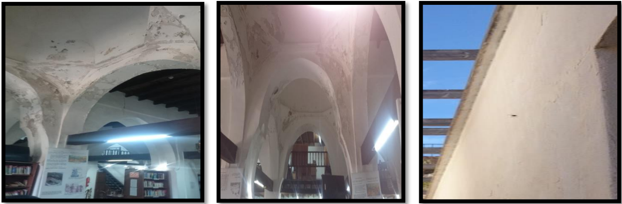
Figure 60 : les pathologies à l'intérieur de la mosquée de Bejaia après la restauration de 2009
