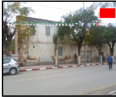
photo 32: construction en mau vaise état
