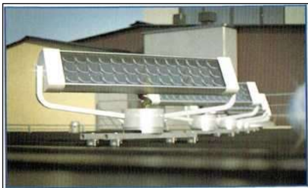
Figure IV.13 : Capteurs de lumière montés en toiture.
