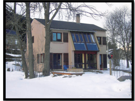
Image n°23 : l'exemple d'installation des capteurs solaires sur un volume du bâtiment.
