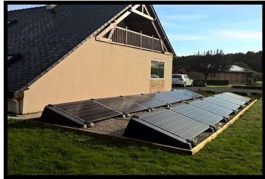
Image n°28: exemple Les capteurs sont disposés à l'extérieur de la maison
