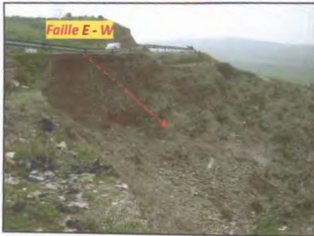
Photo.IV.4 : illustrant l'effondrement de la RN 27 suite à un intense glissement de terrain déclenché en 2003 suivant l'axe de l'accident tectonique orienté E - W.
