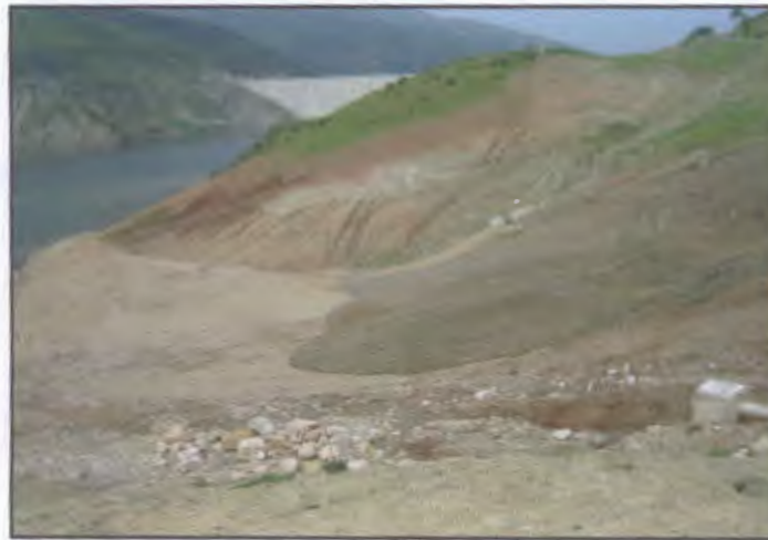
Photo.IV.1 : Illustration des coulées boueuses observées au pied du versant.
