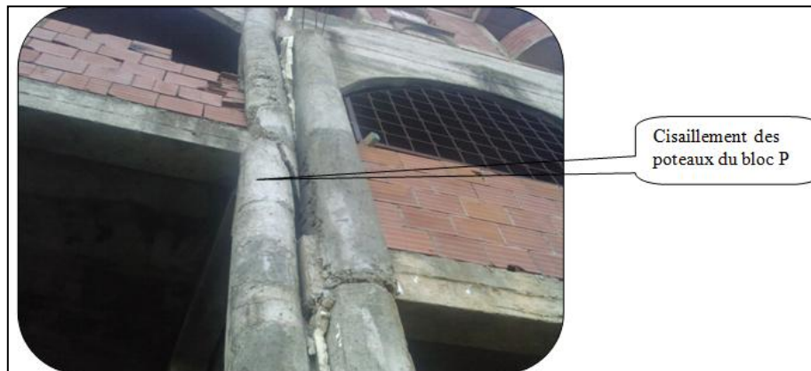
Figure III.20 : Cisaillement des poteaux du bloc P.
