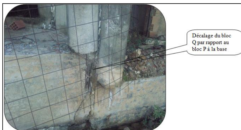
Figure III.21 : Décalage du bloc Q par rapport au bloc P à la base.
