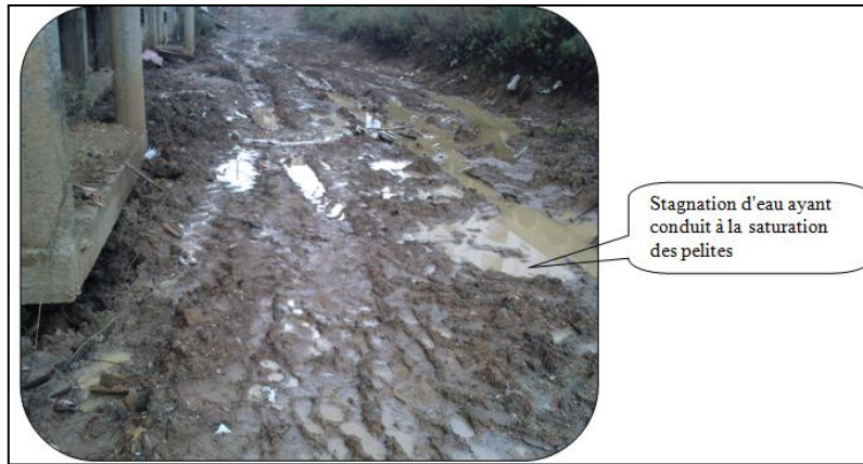
Figure III.19 : Stagnation d'eau ayant conduit à la saturation des pelites.
