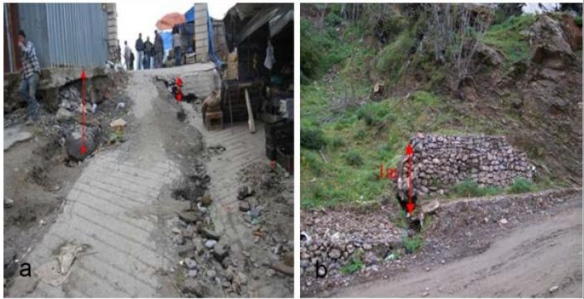
Figure I.14 : Les déformations dans la ville de Ain El Hammam.
