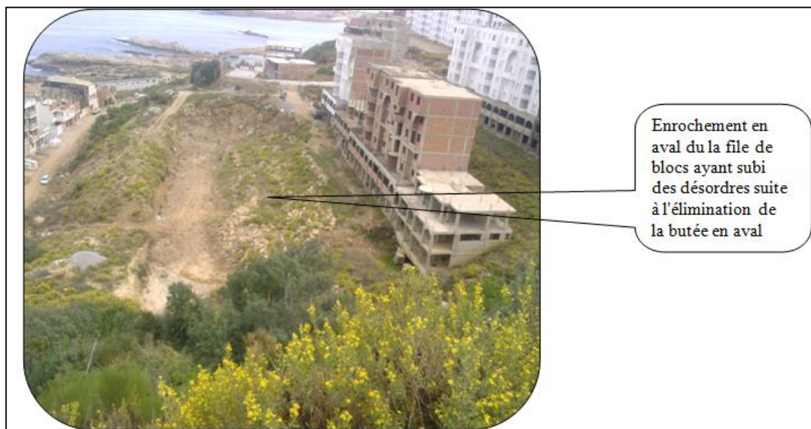
Figure III.7: Enrochement en aval du la file de blocs ayant subi des désordres suite à l'élimination de la butée en aval.
