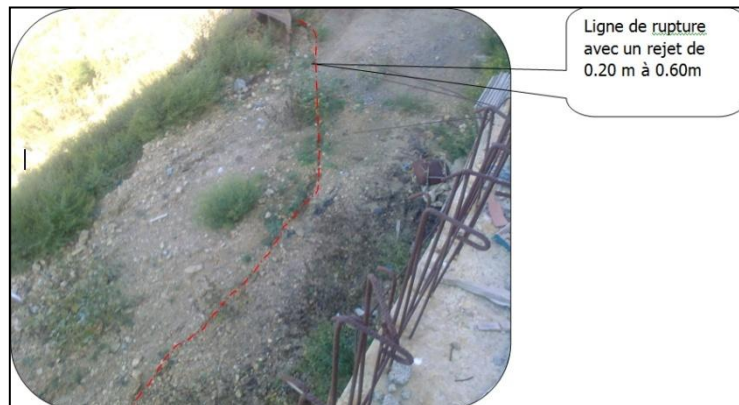
Figure III.15 : Ligne de rupture avec un rejet de 0.20 m à 0.60m traversant le bâtiment P
