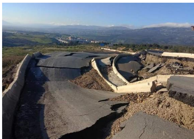
Figure I.2: Affaissement de la route à Azazga, TiziOuzou
