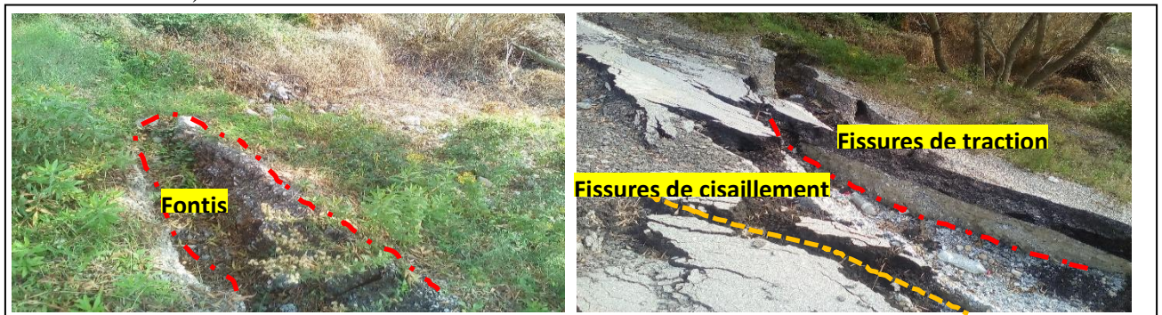
Figure IV.7 : Vue sur les déformations de talus
