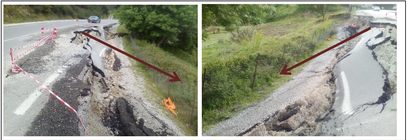
Figure IV.6 : Vue sur les désordres de talus
