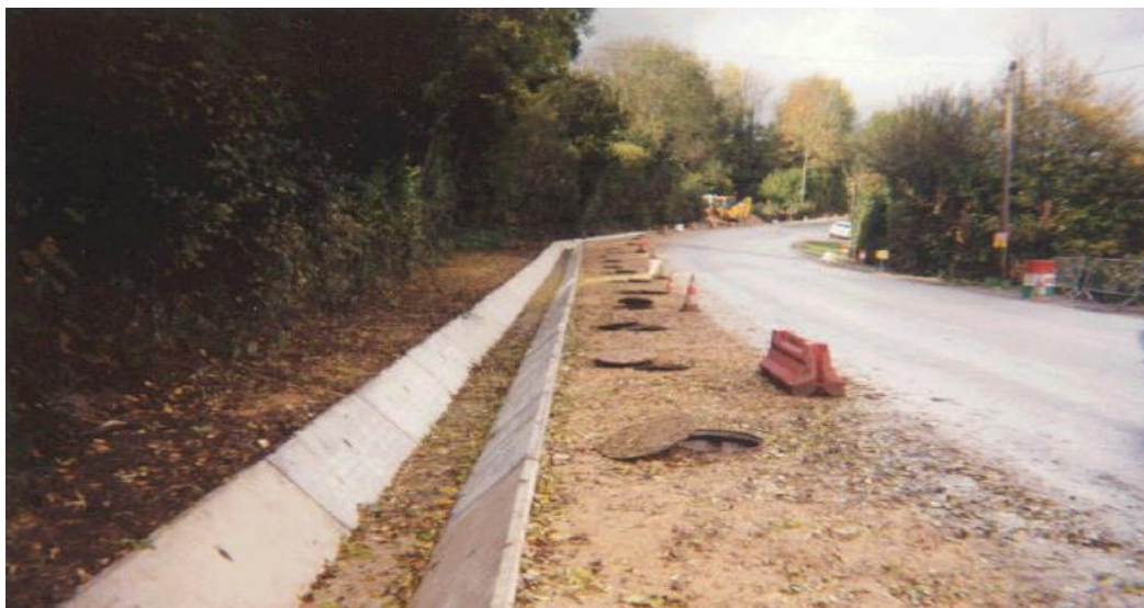
Figure III.6: fossé et caniveaux au bord de la route
