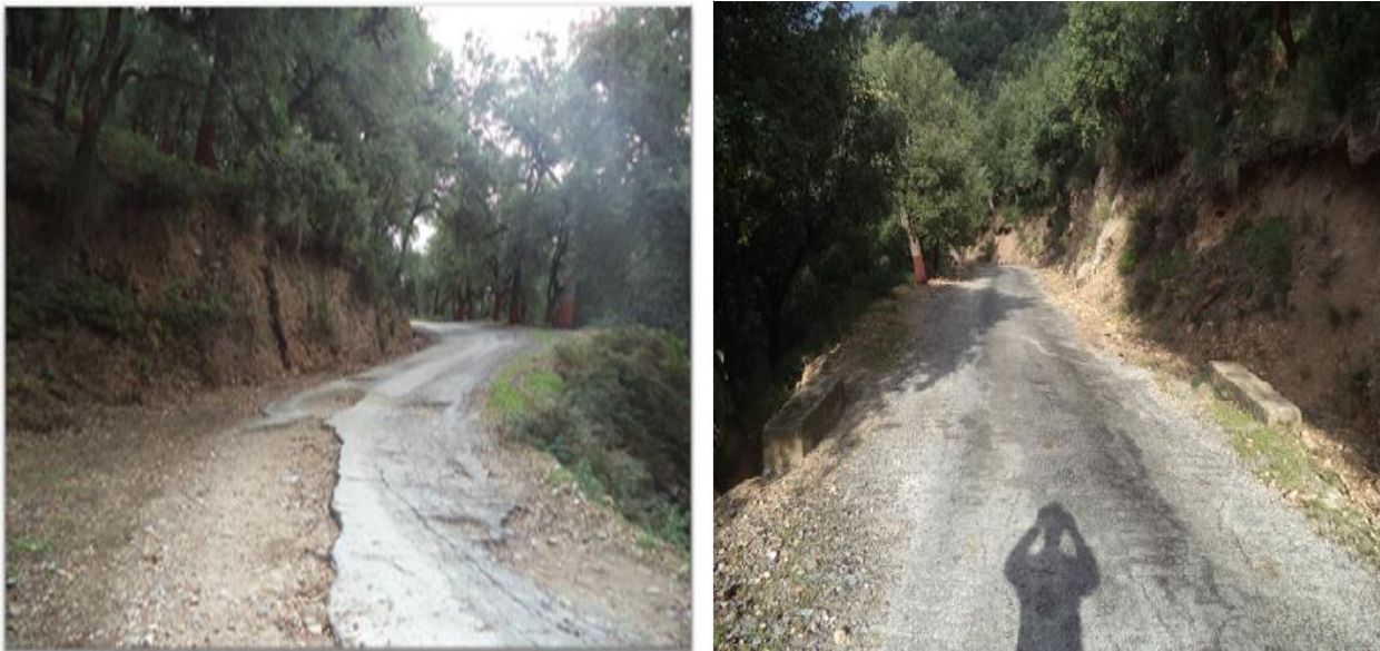
Figure I.3: état actuel de la route.
