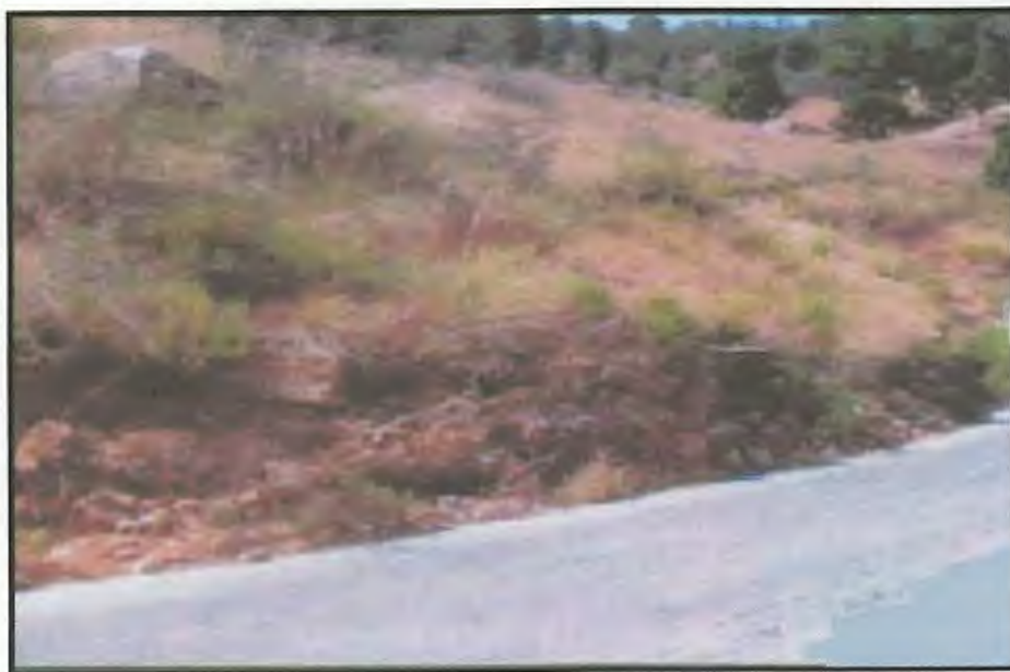
Photo IV.7: Effondrement de mur gabion et éboulement au niveau de talus
