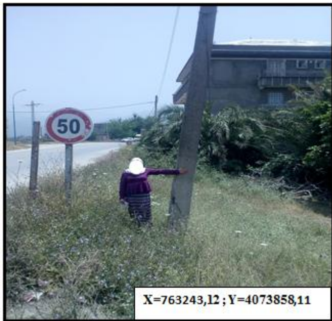
Photo.VI.1. Inclinaison des poteaux électricité glissement de terrain
