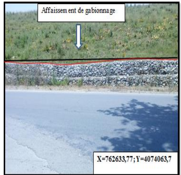
Photo.VI.2. Affaissement de gabionnage
