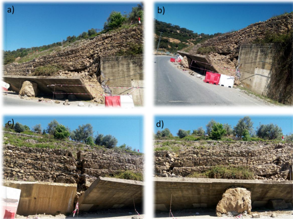
Figure 27 : Photos illustrant les désordres affectant le mur de soutènement et le gabionnage (stage de terrain en 2016/2017)
