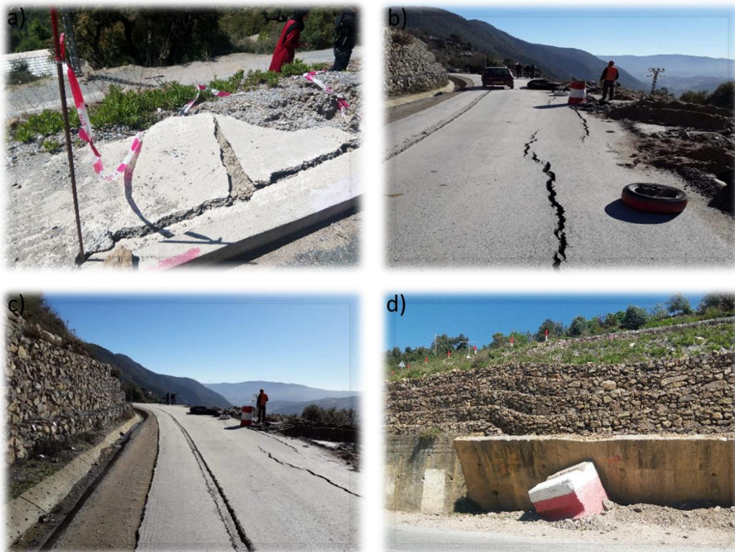
Figure 28 : Photos illustrant les désordres affectant la chaussée du CW137A
