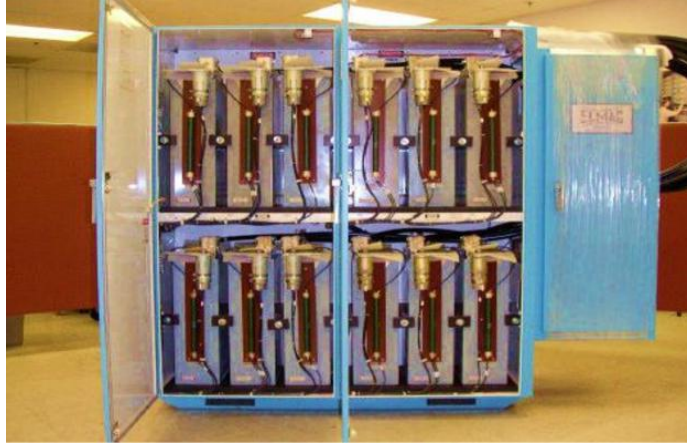
Figure I.9: Equipement de stockage d'énergie [26]
