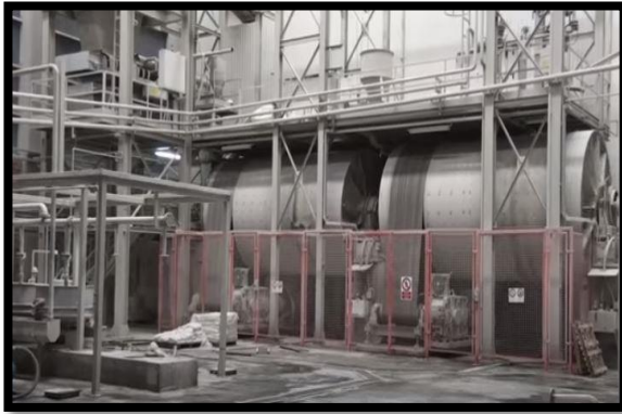
Figure I.8 : Les réservoirs mélangeurs
