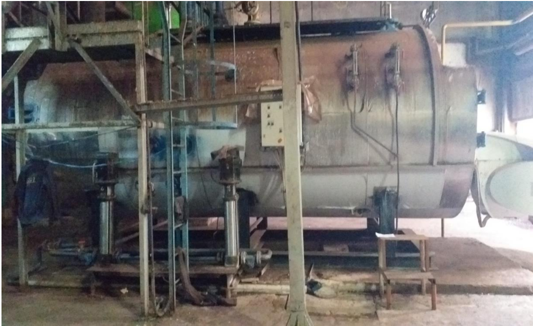
Figure II.3. Chaudière de la vapeur.
