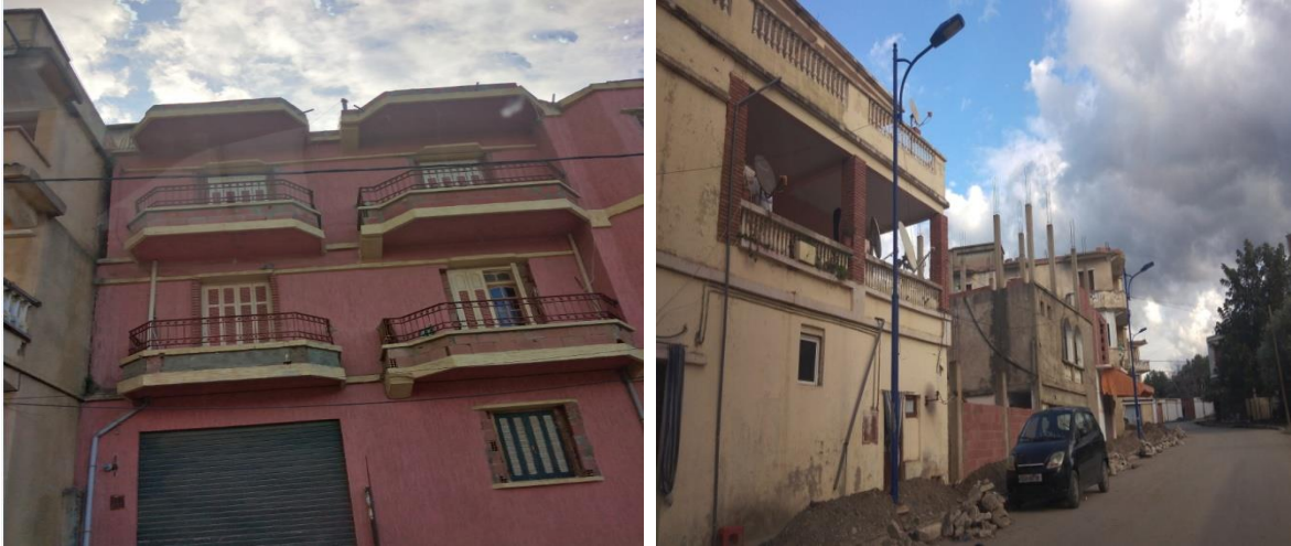
Figure 22 : les constructions en état d'infraction
