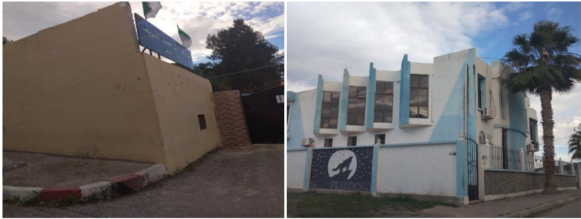
Figure 24 : infractions au niveau de la clôture
