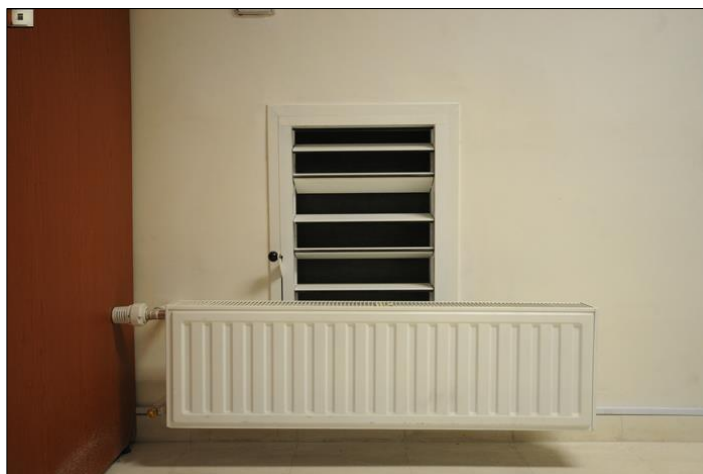
Figure III-08 : Une bouche d'air en bas de mur.
