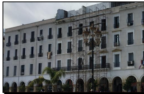
صورة رقم 18 : ترميم دار حسن باشا بمواد بناء حديثة المصدر : تصوير الطالب 2019
