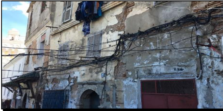
صورة رقم 13: واجهة مبنى بها اسلاك كهربائية المصدر: تصوير الطالب 2019
