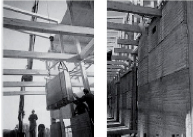
Figure 19.assemblage et pose de blocs de pisé sur le lieu du chantier ; Source : CRAterre
