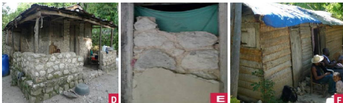
Photo30 : (d) ossature en bois avec tiwoch (e) tiwoch, endommagement dû au séisme ; (f) palmiste, abris d'urgence post-séisme réalisée par la population.
