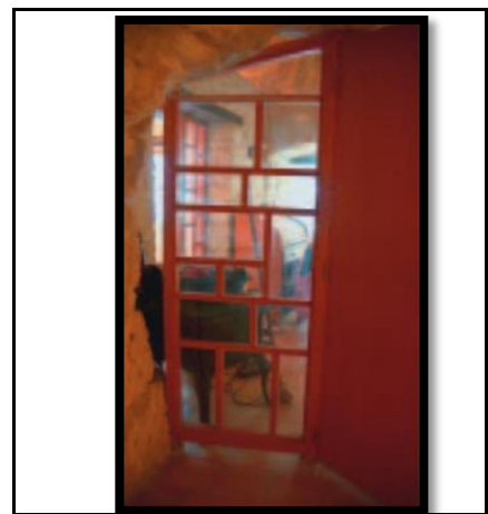
Photo III.4 : Les cloisons réalisées pour isoler les chambres, sont détachés des parois pour conserver une circulation d'air.
