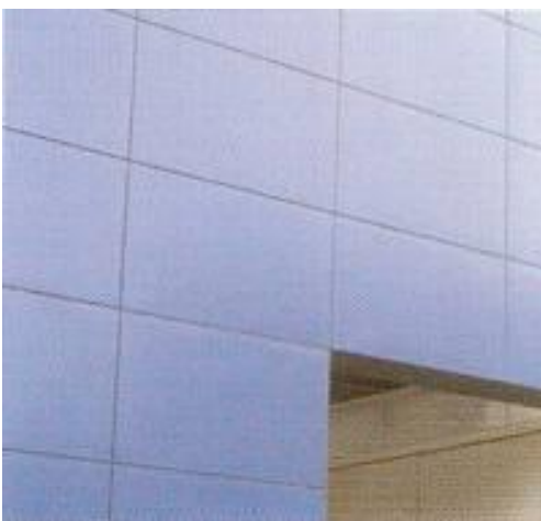
Figure 12 : Façade en panneaux simples (cassettes).
