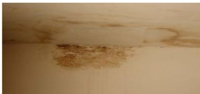
Photo II.16 : Les fuites provoquent des problèmes d'humidité très localisés
