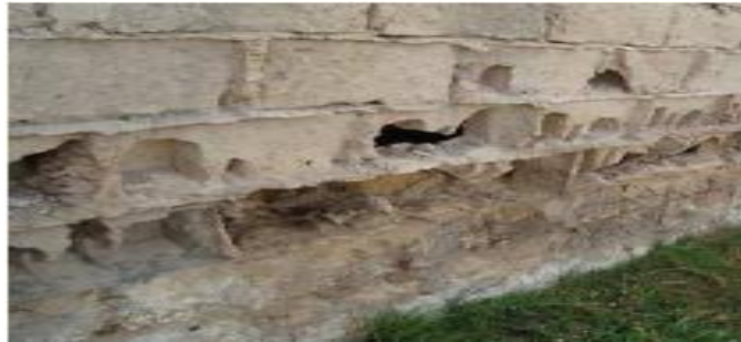
Photo II.9: Dégâts sur la maçonnerie
