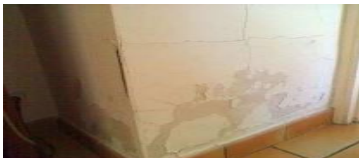
Photo II.15: dégâts sur les crépis
