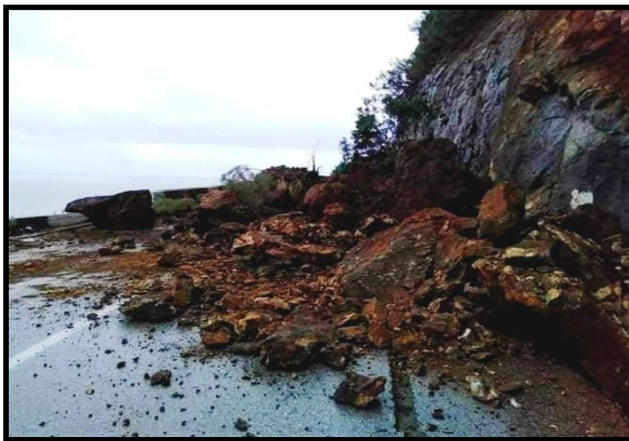
Figure IV.3. Exemple d'éboulement au niveau de la RN 43, janvier 2019 (El Aouana)
