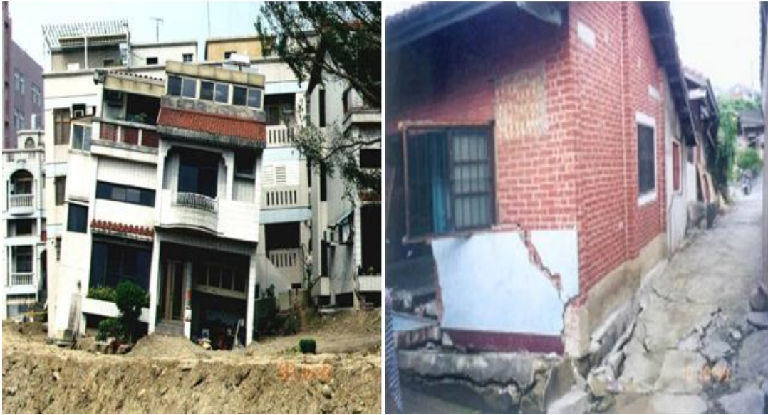
Figure I.14 Endommagement de bâtisses dû à la liquéfaction en Taiwan
