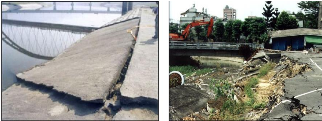
Figure I.15 Dommages dus à l'épandage latéral du sol en place
