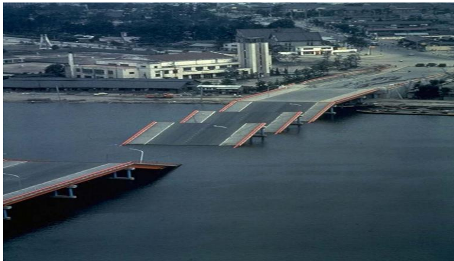
Figure I.4 Rupture du pont de Showa, à Niigata au Japon, dues à l'épandage latéral dans le sol [3]
