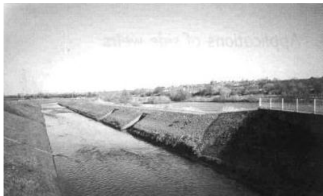
Figure (I.20) : Déversoir en terre renforcé avec blocs en béton sur un canal de contrôle des crues
