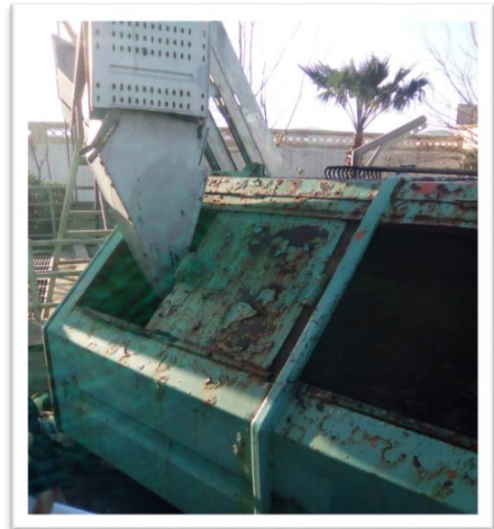
Photo 02 : Les déchets de dégrillage (STEP de la ville de Jijel)
