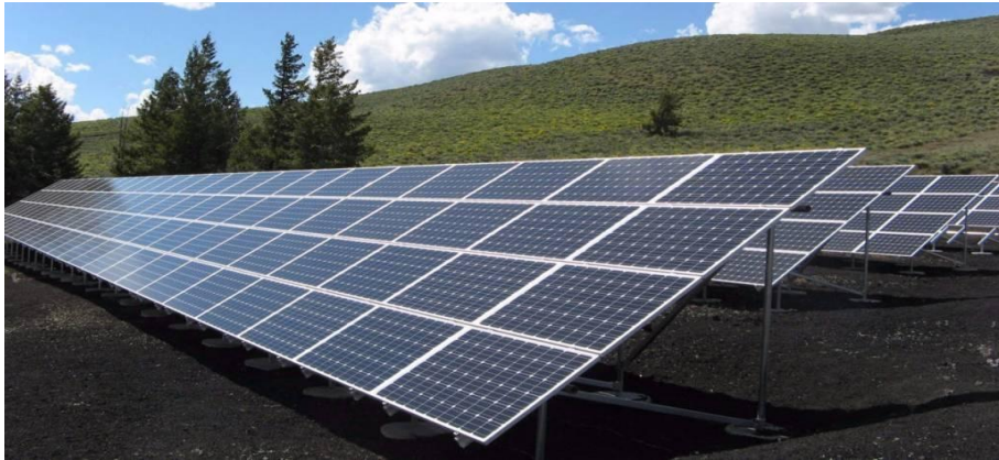
Figure I.4. Exemple d'un générateur photovoltaïque
