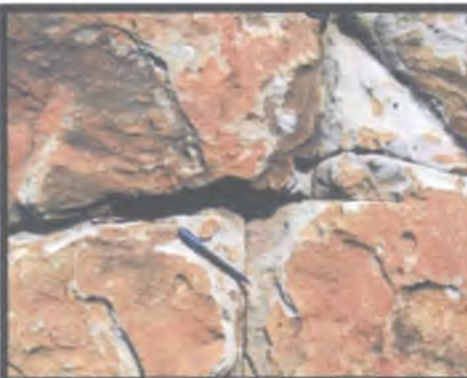
Photo.III.3 : Diaclase au niveau de banc de grès (vue de haut).
