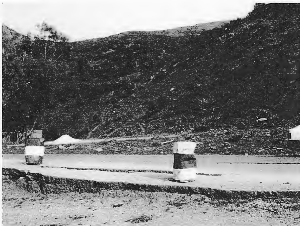
Photo 5 : Rupture de la route.
