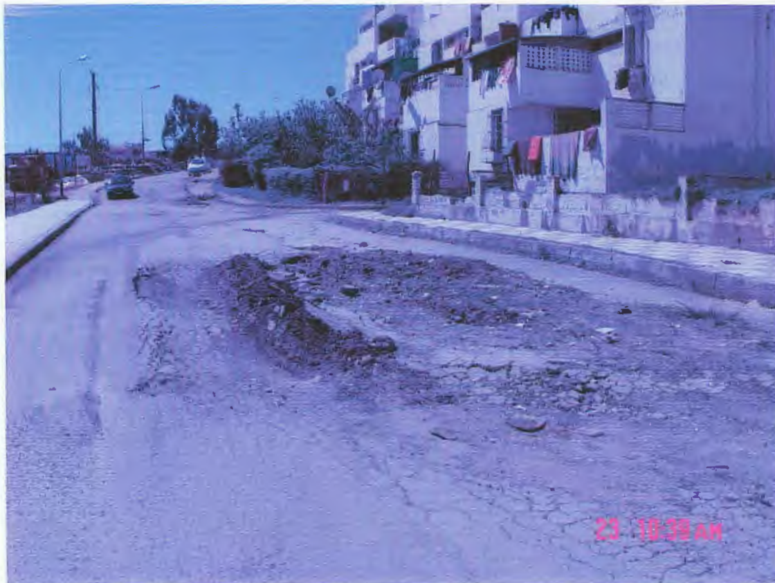
Photo. V.1 : Déformation de la chaussée (Photo prise le 23-05-2005)
