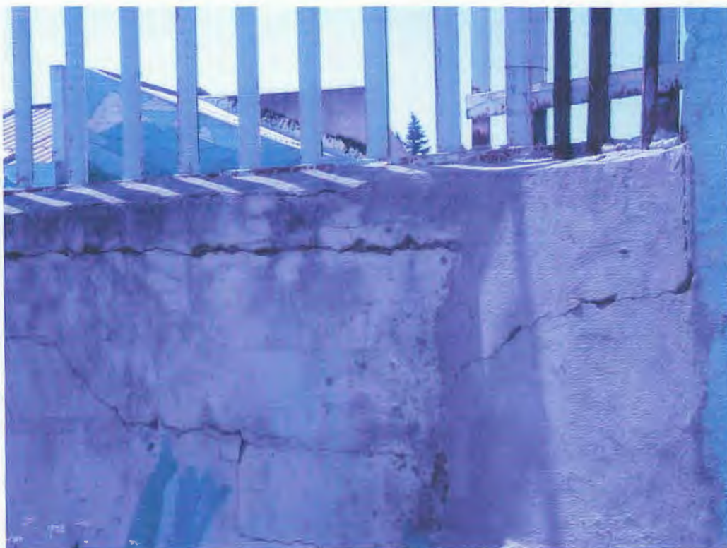
Photo. V.2 : Fissuration du mur de clôture (Photo prise le 27-06-2005)
