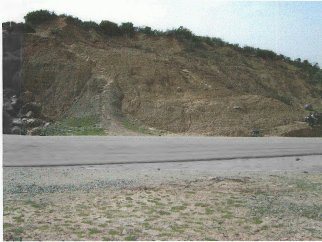
Photo 8: illustration d'une coulée boueuse sur la rive gauche de la RN77 ' Est du lycée d'El-Gheriana.
