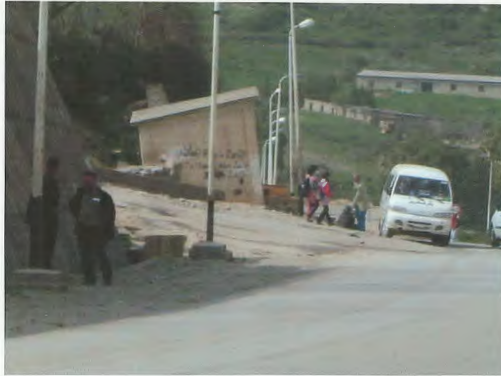
Photo 7 : Illustration du mouvement de terrain de l'arrêt de bus d'Elgheriana (déformation de la chaussée et de l'abri bus)
