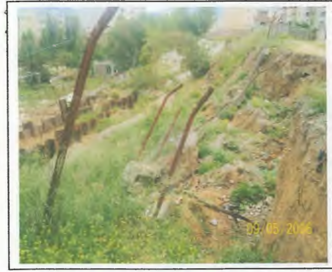
Glissement d'une partie du versant.
