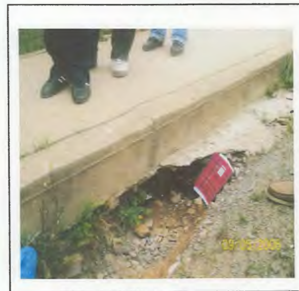
Absence de tout système de drainage.
