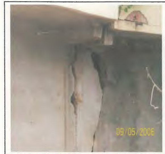
Fissures au niveau des murs d'une maison.
