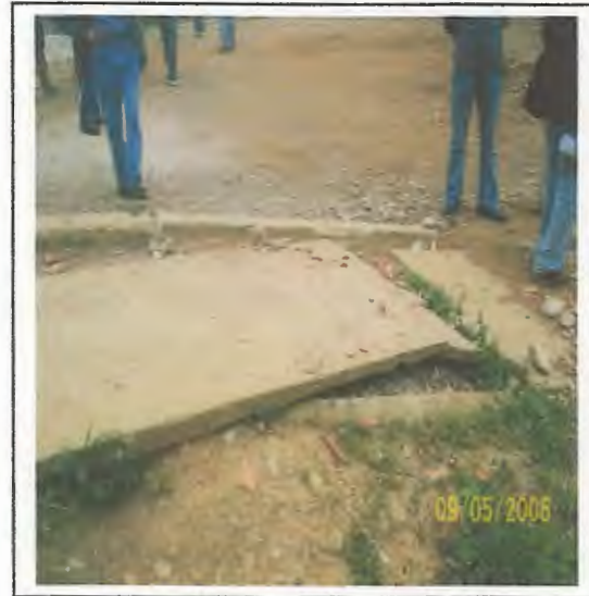
Destruction du trottoirs suite au mouvement du sol.
