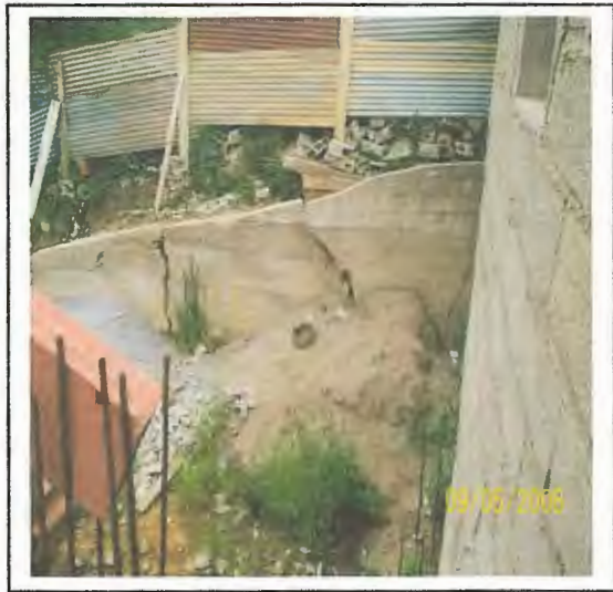
Fissuration au niveau des murs de soutènements.
