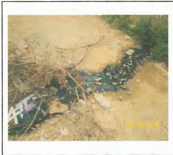
Infiltrations parasites des eaux usées.
