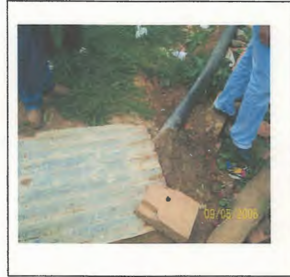
Manque des regards d'égouttement
