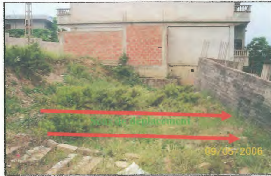
Fig-VII-6 : Déplacement du rez de chaussé d'une maison En amont du talus.
