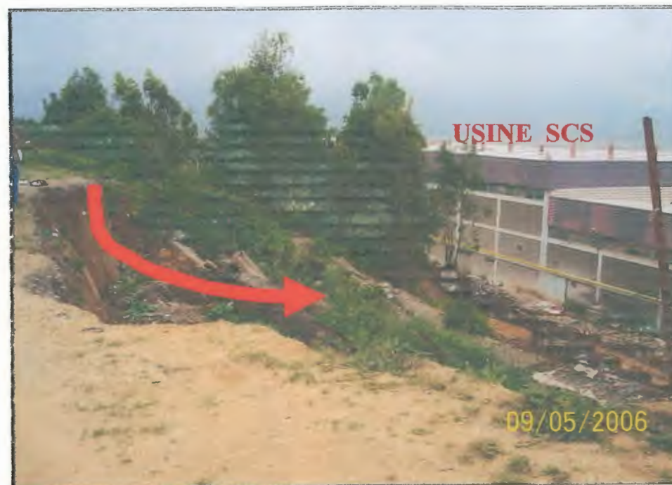
Fig-VII-7 : Rupture circulaire en aval du talus (derrière l'usine S.C.S).
