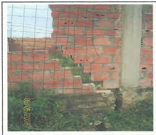
Fissures dans les murs d'une construction
