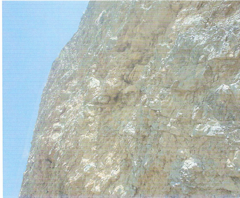
Photo 5 : Stations N°3 (zone complètement broyée)
