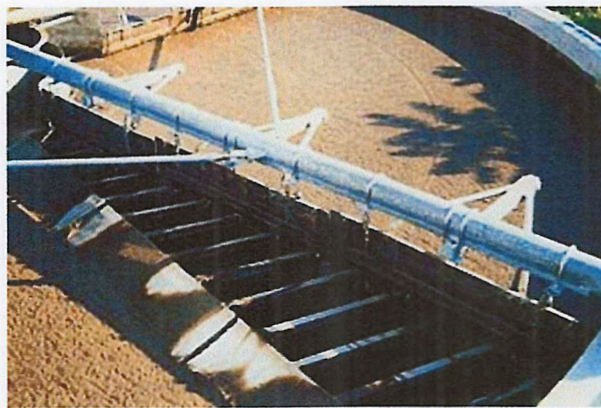
Figure 7. Épaississement des boues par flottation.
