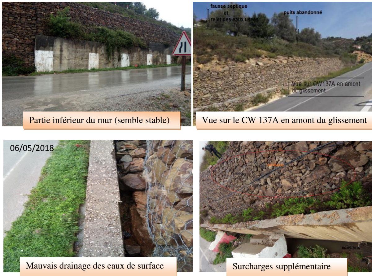
Figure.VI.9. Désordres affectant le glissement de terrain étudié.
